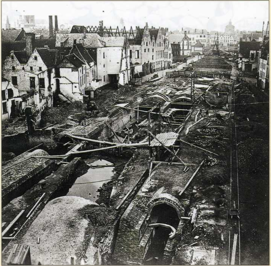
Le voûtement de la Senne à hauteur du Boulevard Anspach (ca 1870), (©IRPA-KIK, Bruxelles).
